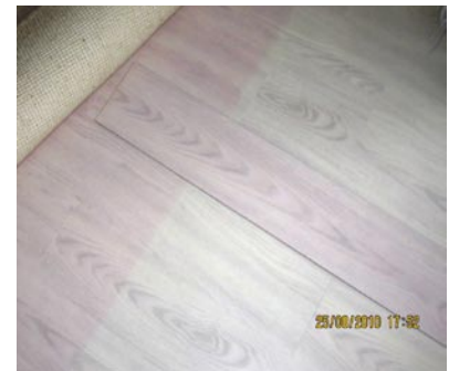
Das Foto 5 zeigt dann beispielhaft ein Kautschuk-/Gummibelag, welcher sich ebenfalls durch Sonneneinstrahlung und UV-Lichteinwirkung deutlich verfärbt hat.
