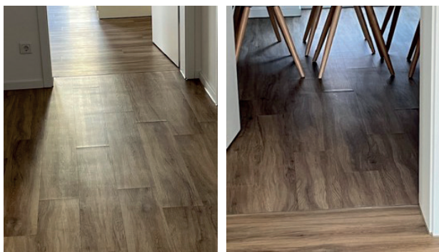
Bilder 1 und 2: Stoßkantenerhöhungen an den Kopfenden/Strinseiten der Bodenbelagsplanken durch Temperatureinwirkung
