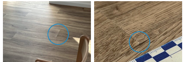
Bild 3 und 4: Folgeschäden an den Stoßbereichen der Kopfenden
