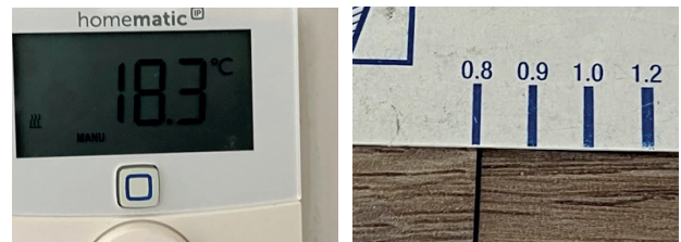
Bild 5 und 6: Fugenöffnungen bei geringeren Temperaturen (nicht unüblich)
