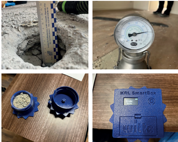
Bilder 13 bis 16: zu hohe (Rest)-Feuchte im Untergrund (CM + KRL)
