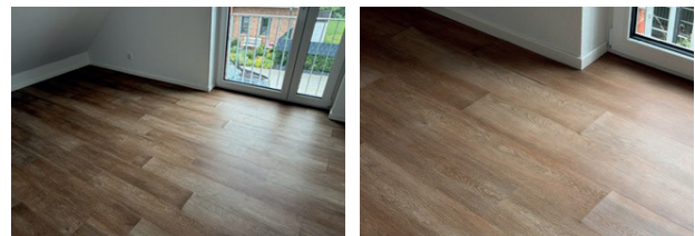
Bild 7 und 8: Stoßkantenerhöhungen bei hohen Temperaturen
