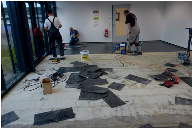
Die PVC-Design-Planken haben sich durch aufsteigende Feuchte abgelöst
