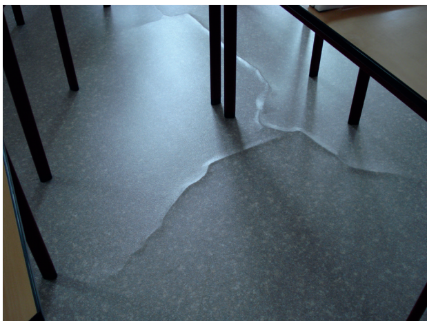
Beulen und Blasenbildung durch aufsteigende Feuchte durch Tauwasserbildung
