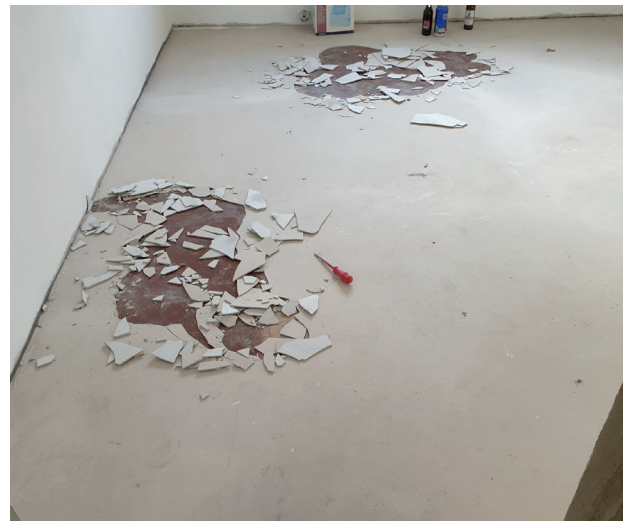
Abplatzen der Spachtelmasse aufgrund aufsteigender Feuchte aus dem Untergrund
