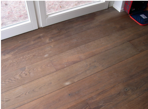
„Reparaturstellen“ mit hellen Flecken
