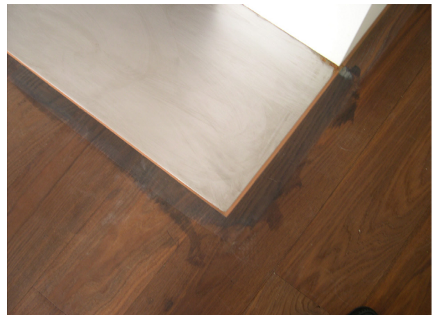
Dunkle Flecken rund um die Cheminéebodenplatte
