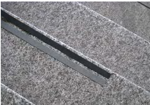
Abbildung 25 Antirutsch-Bänder machen auf Treppenkanten aufmerksam
