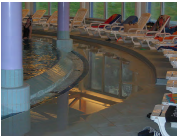
Abbildung 14 Kein Gefälle vorhanden, Wasserabfluss funktioniert nicht
