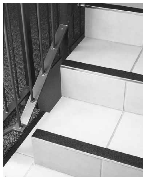
Bild 2: Nachträglich angebrachte Gleitschutzstreifen auf einer glatten Steintreppe.
